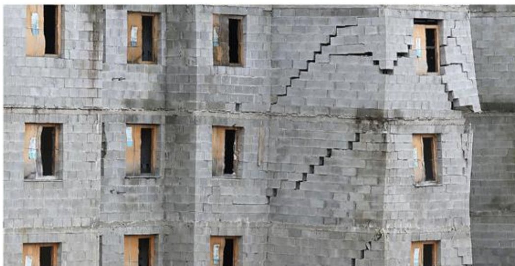
Figura 1 - Trinca em Alvenaria Estrutural provocada por recalque na fundação.
